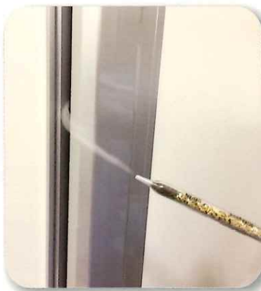
室圧・気流方向検査
